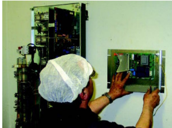
Quadro di interfaccia
